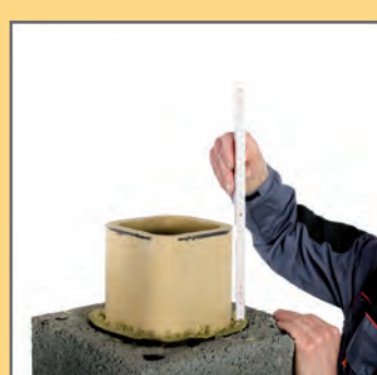
20. Odmierzyć żądaną długość rury ceramicznej tak, aby ceramiczna osłona wylotu kominu znalazła się 1 cm powyżej płyty przykrywającej. W razie potrzeby rurę skrócić szlifierką kątową.
