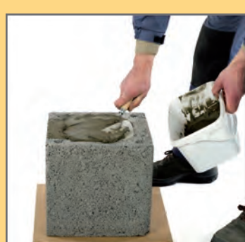
1. Na warstwie izolacji (np. folia budowlana, papa) ustawić pustak i wypełnić go zaprawą na odpowiednią wysokość tworząc cokół. Wypoziomować.
